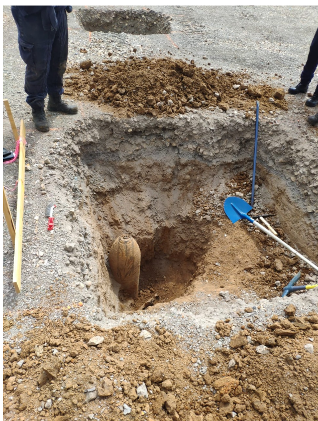
Bombe de 250 kg déterrée dans un parking en cours de rénovation, mars 2025
